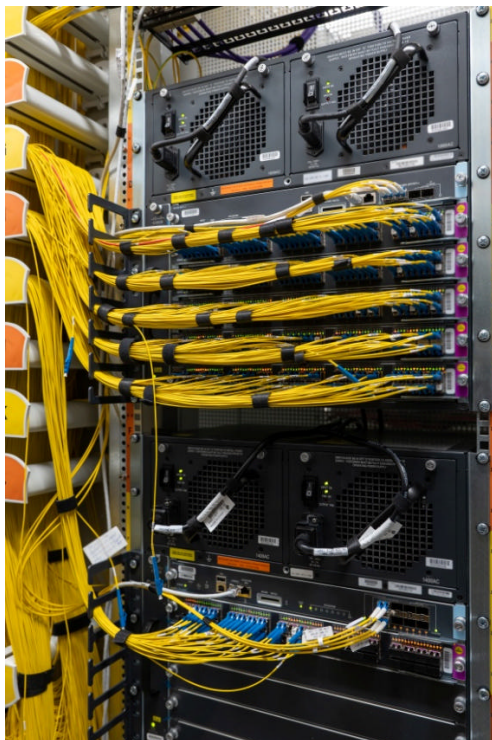
Voorbeeld van een AON OLT. Hier is te zien dat elke aansluiting een eigen poort nodig heeft.
