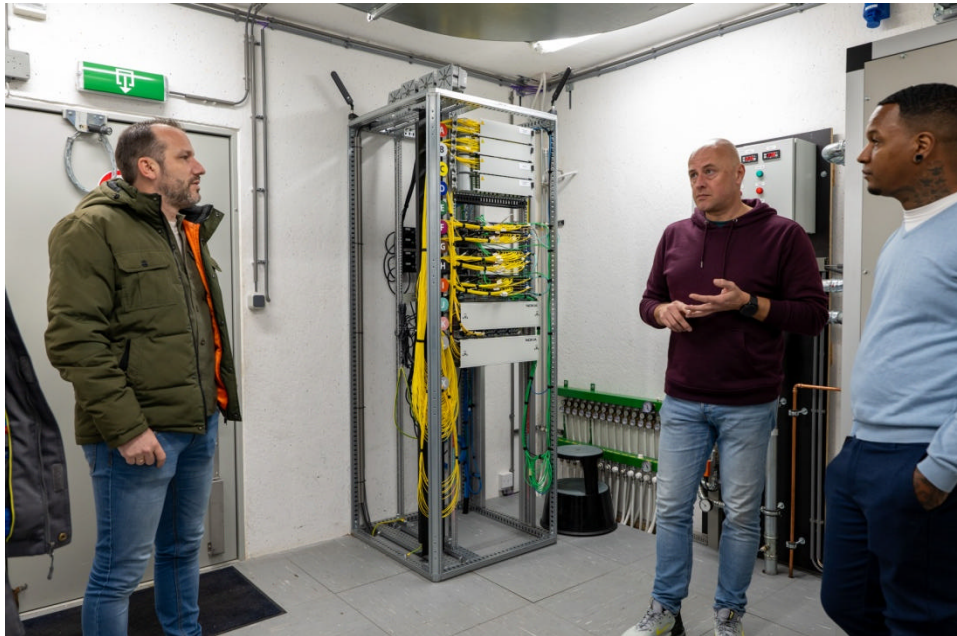
Uitleg over het uplink routing rack en de klimaatbeheersing binnen deze POP. Links @fagao in het midden hun collega René (verantwoordelijk voor bouw van o.a. POPs) en rechts @R3D.
